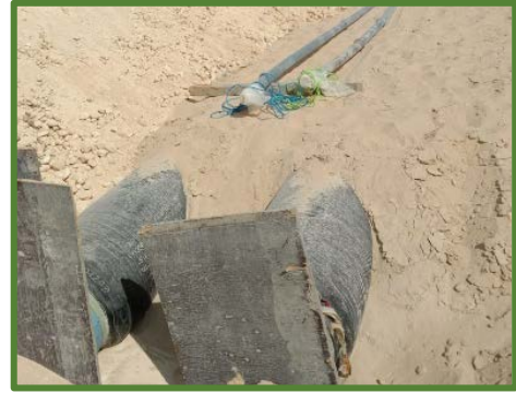
Fiber Optic Conduits
